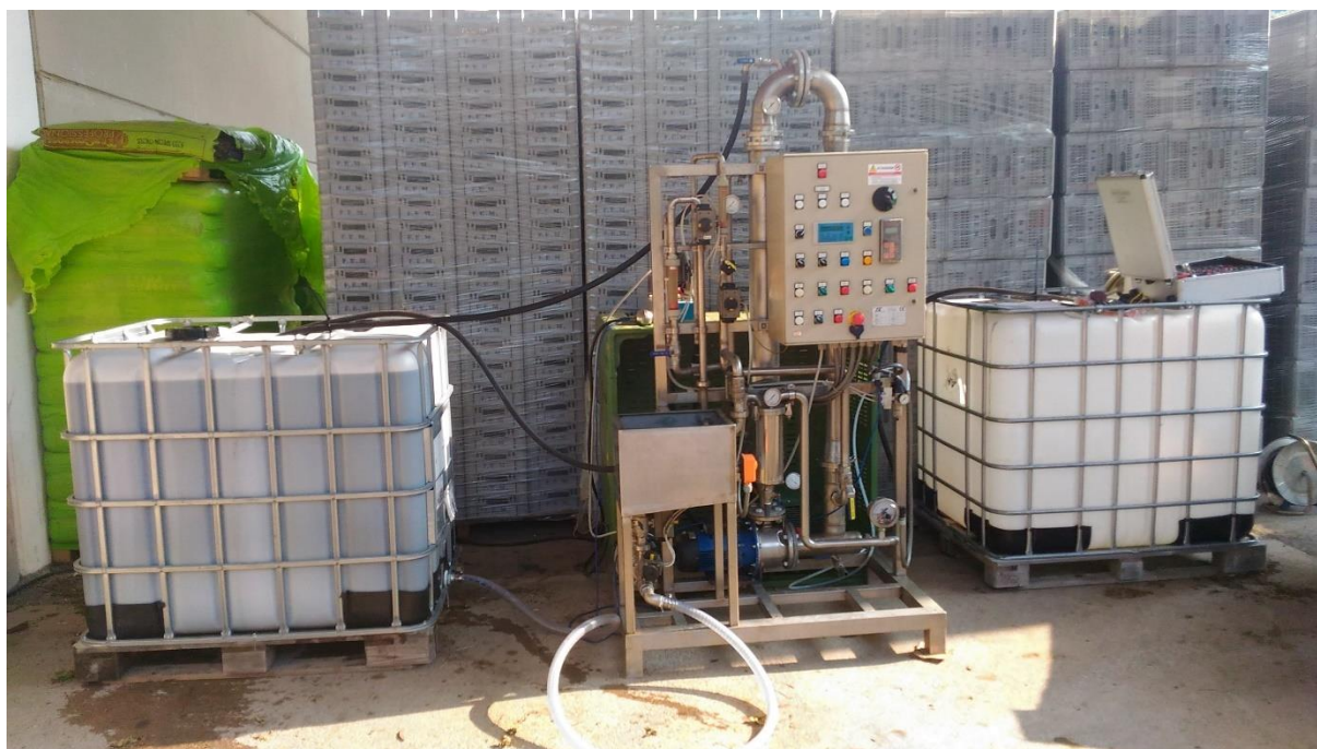
Immagine 15: Impianto di ultrafiltrazione – Angeli Idraulica (Foto: FEM)
