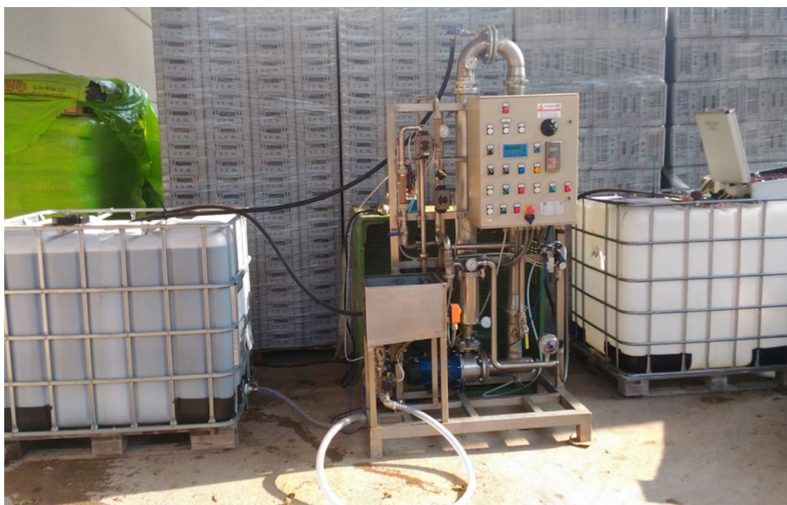
Immagine 20: Sistema ad ultrafiltrazione per il trattamento e il riutilizzo dell'acqua
