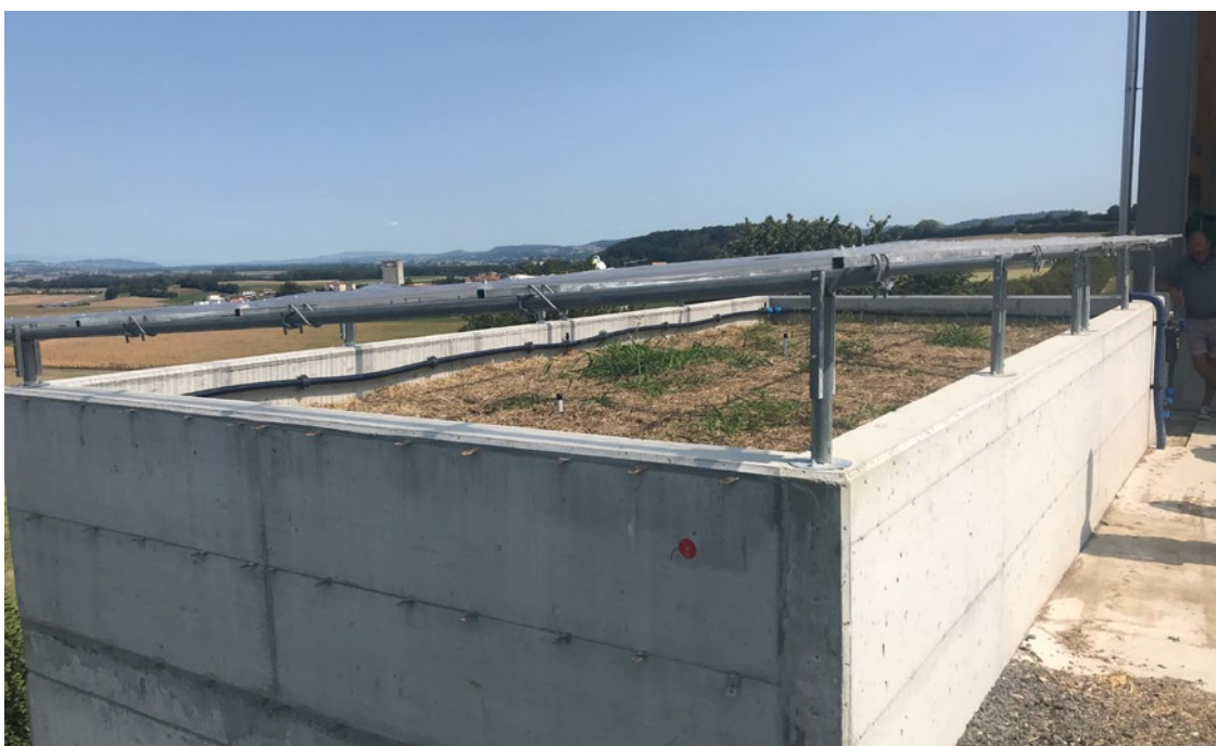
Immagine 16: Sistemi di evaporazione su substrato biologico coperto in vasca di cemento (Friburgo, Svizzera)
