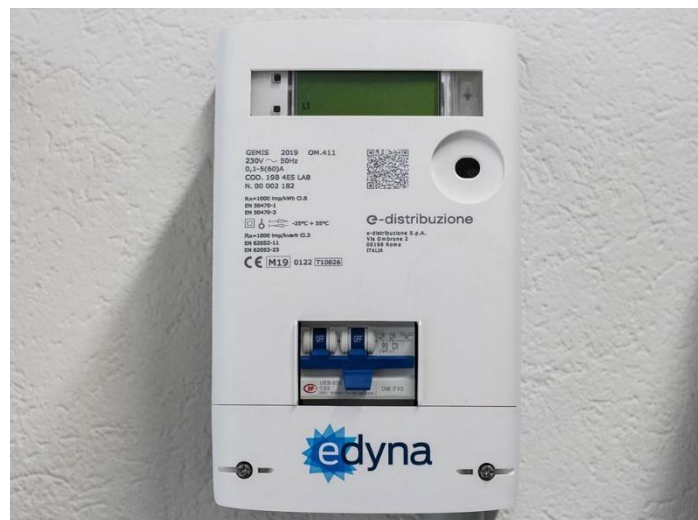
Abbildung 3: Intelligenter Stromzähler, auch Smart Meter genannt (Bild: Edyna)
